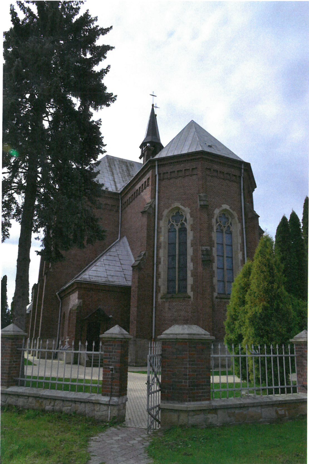
Fot. nr 1 Kościół pw. Św. Marcina w Krościenku Wyżnym. Widoczne: zabrudzenia powierzchni elewacji kościoła w części północnej.
