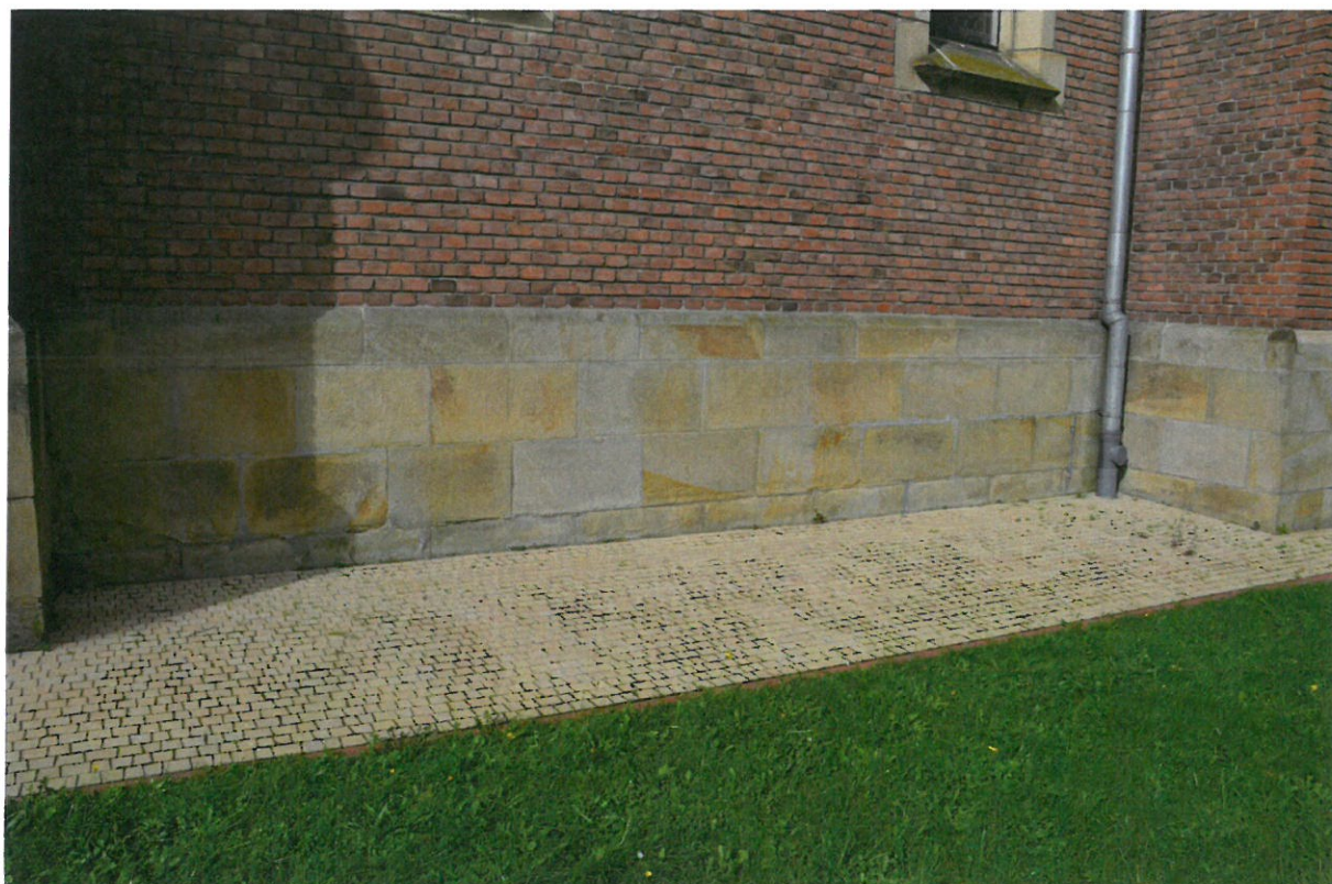
Fot. nr 1 Kościół pw. Św. Marcina w Krościenku Wyżnym. Widoczne: rozwarstwienia kamienia, obszerne ubytki formy rzeźbiarskiej powstałe w skutek dezintegracji strukturalnej kamienia, zabrudzenia powierzchniowe. Fot. Mariusz Wrona październik 2023 r
